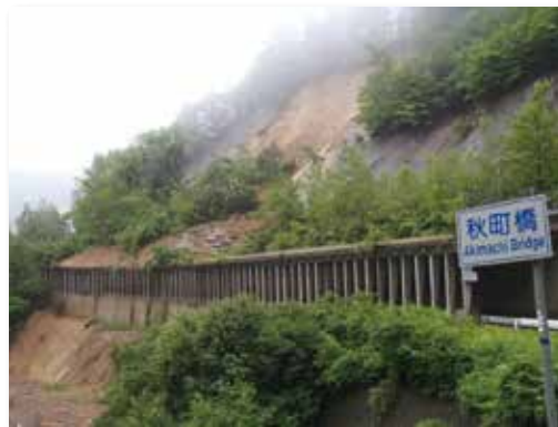
尾神地内 国道156号法面崩壊
