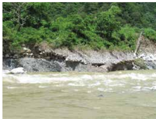
御母衣地内 護岸決壊
